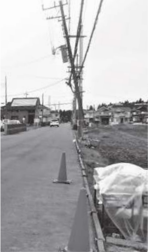
傾いた電柱が、衝撃の激しさを物語っている。
