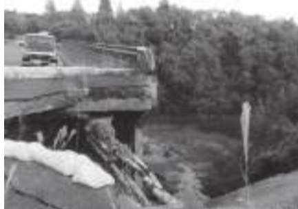
佐倉市側から見る明神橋崩落現場
